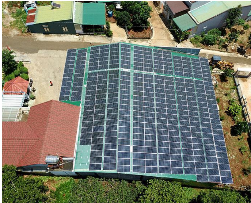
Hình 45: Dự án ĐMT mái nhà tại tỉnh Đắk Nông (135 kWp)
