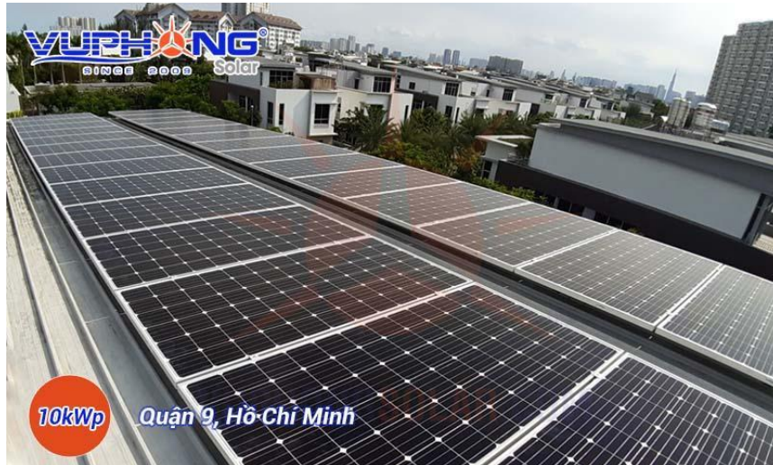
Hình 44: Dự án ĐMT mái nhà tại Quận 9, TP. Hồ Chí Minh (10,08 kWp)
