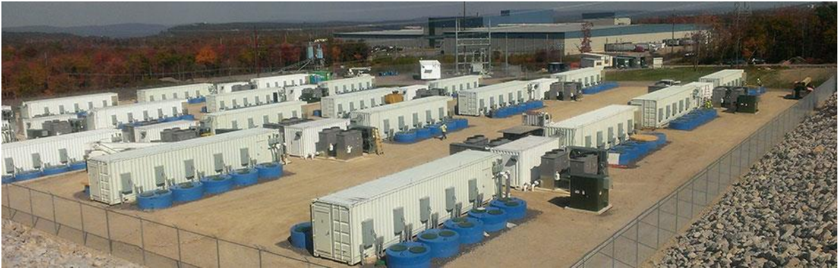
Hình 32: Ảnh nhà máy bánh đà hoạt động thương mại tại PJM, Hazle, Pennsylvania. Nhà máy có 200 mô-đun bánh đà chôn dưới đất phía hai cạnh bên container. Nhà máy cung cấp dịch vụ điều tiết tần số công suất 20 MW cho PJM, đi vào hoạt động đầy đủ công suất tháng 7/2014 [6].
