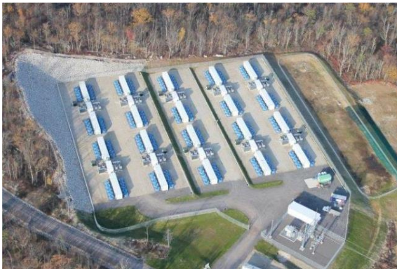
Hình 35. Nhà máy 20 MW của Beacon Power tại xã Hazle, Pennsylvania – Năm 2013
